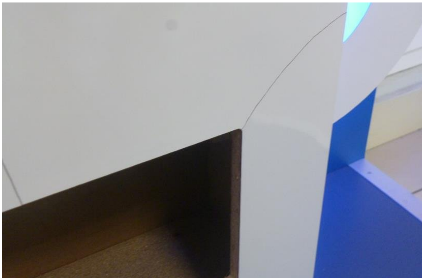
Фото № 5. Фиксация трещины в угловом сегменте технологического отверстия №2.
