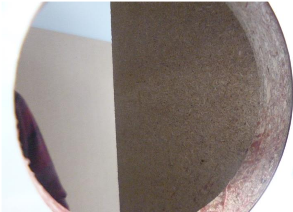
Фото № 10. Отверстие под электропроводку: на ДСП остаточный клеевой состав.
