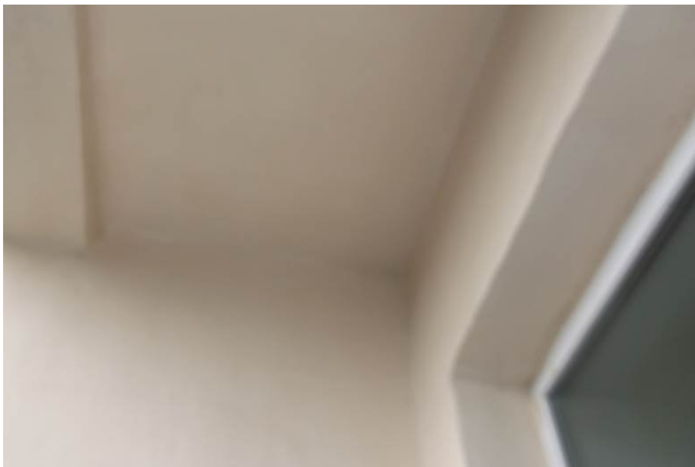
Фото № 2. Примыкание балконной плиты кв. 38 к стене здания.
