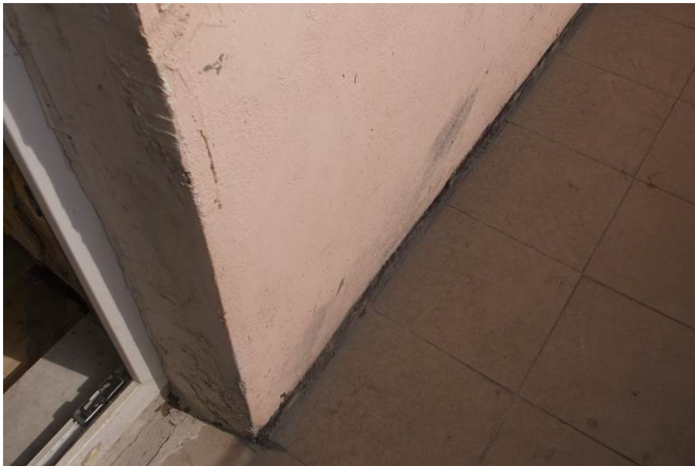
Фото №1. Состояние примыкания балконной плиты кв. 38 (вид с 6-го этажа).
