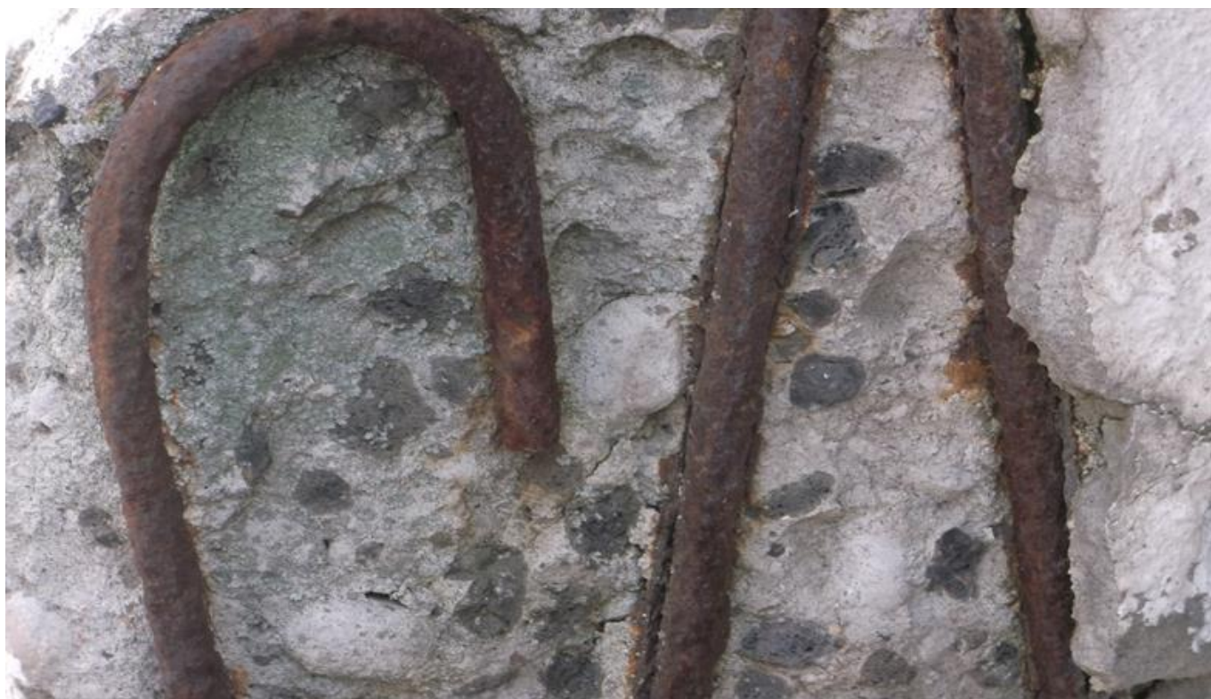
Фото № 5. Общий вид разрушения бетонного слоя.
