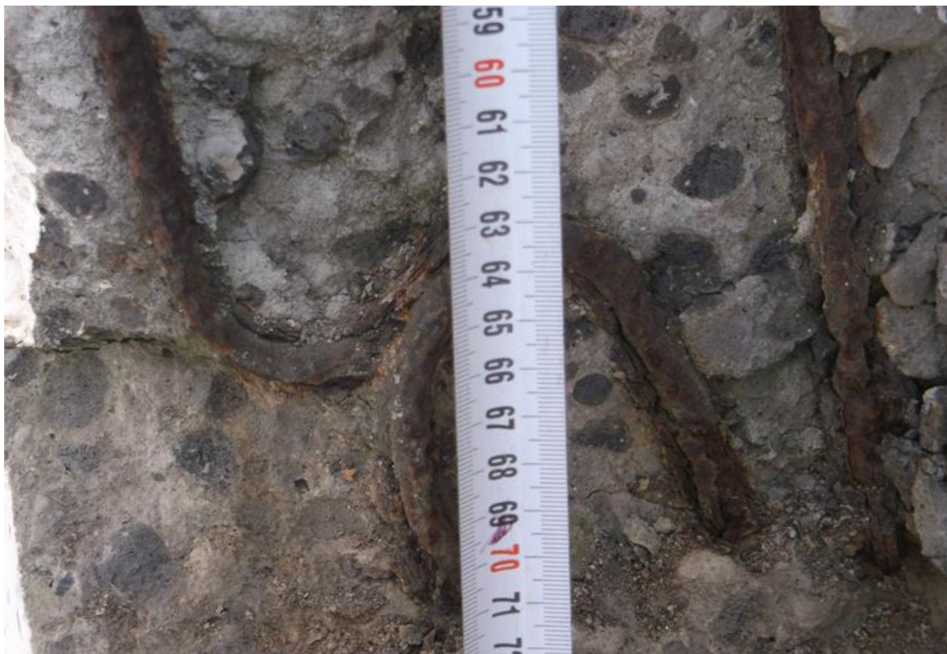
Фото № 4. Фиксация разрушенного участка бетона по высоте, равная 700 мм.
