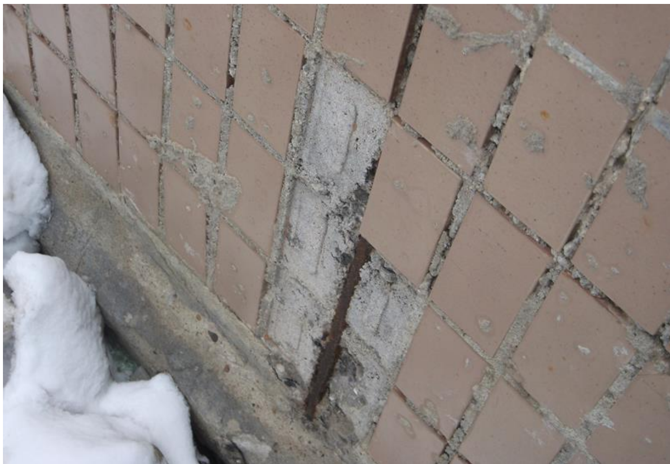
Фото № 7. Обнажение арматуры на фасадной части стеновой панели.
