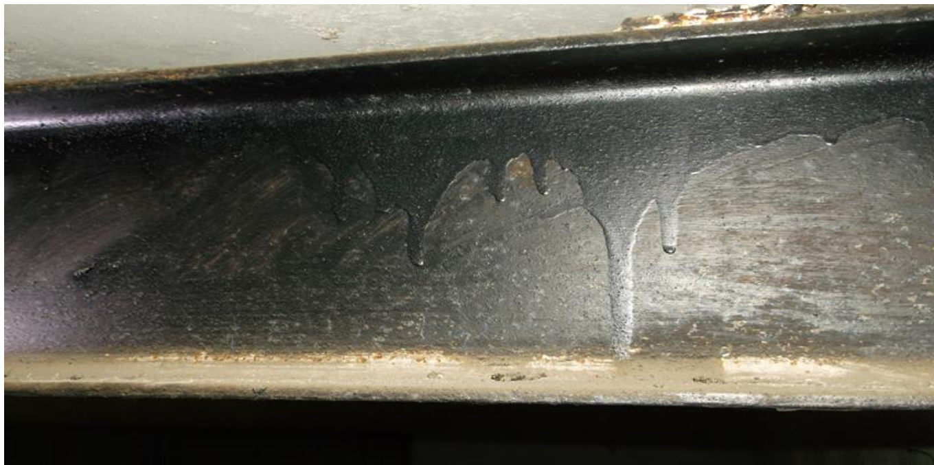
Фото № 31. Общий вид подкрановой балки с прогибом и искривлением.
