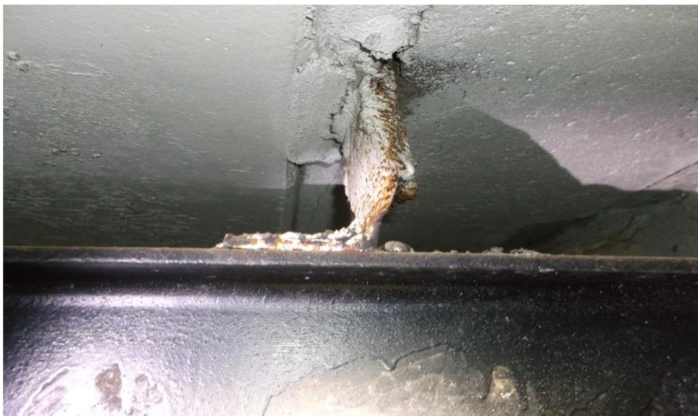
Фото № 33. Образование ржавчины в стальных закладных связях.
