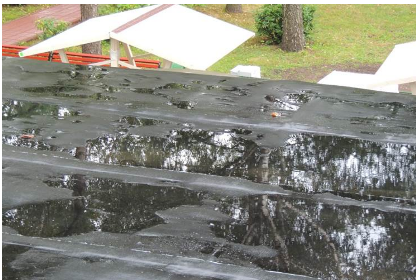
Фото № 4. Не проваренные швы покрытия кровли.
