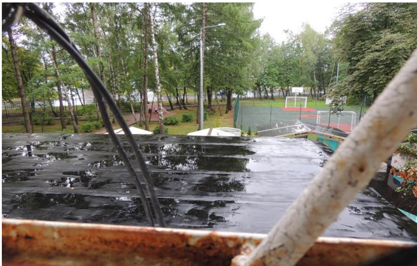
Фото № 5. Не проваренные швы покрытия кровли.
