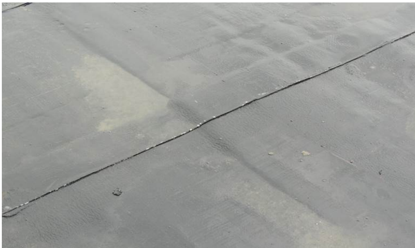
Фото № 1. Не проваренные швы покрытия кровли.
